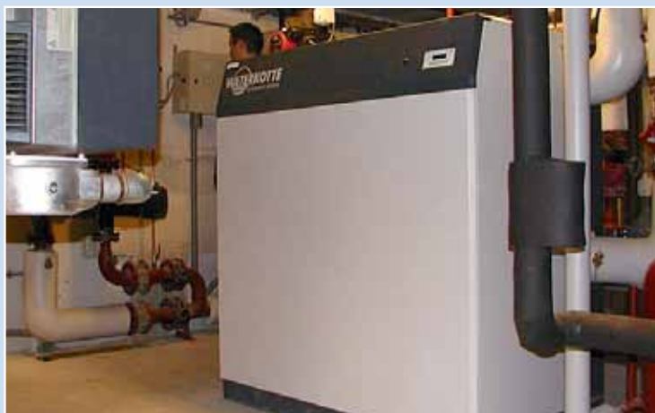
Warmtepomp in ketelhuis van appartementenflat
